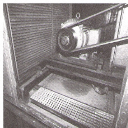
Foto 2: Vervuilde LBK: Oude installatie: overal vocht.
